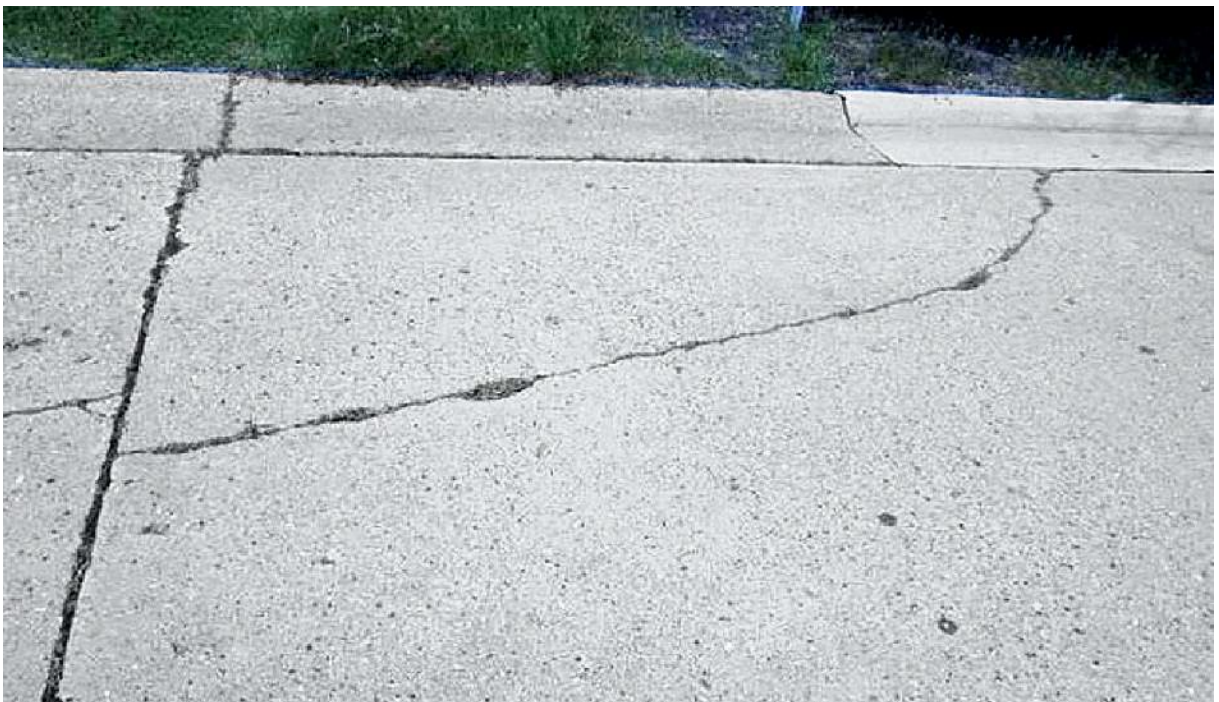
Rys. 5.2.2.7. Widok pęknięcia naroża z częściowym wykruszeniem
