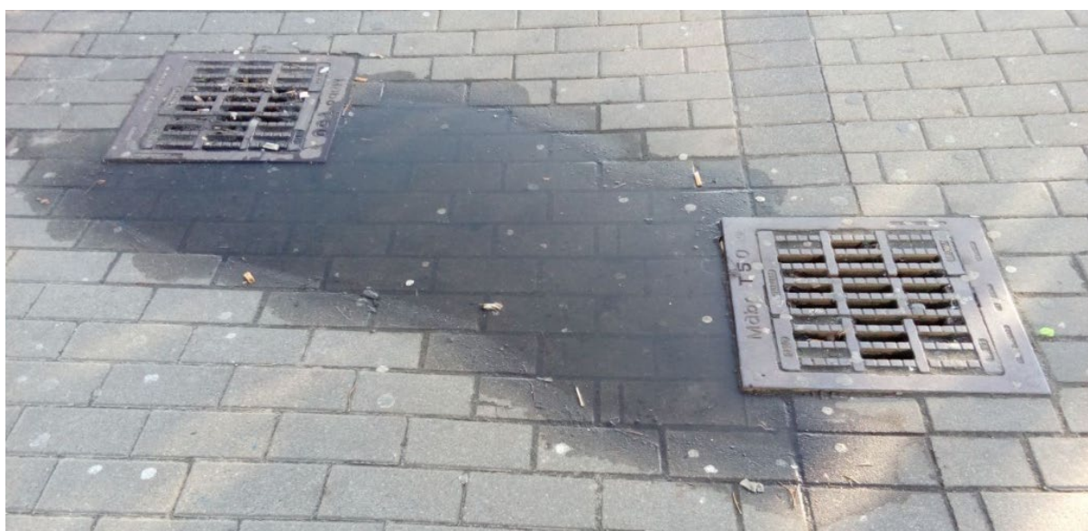
Rys. 6.6. Zapadnięcia lokalne bez ubytków
