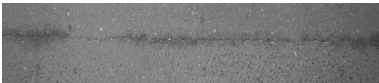
Rys. 5.1.2.11. Spękanie termiczne pojedyncze w połączeniu technologicznym [6]
