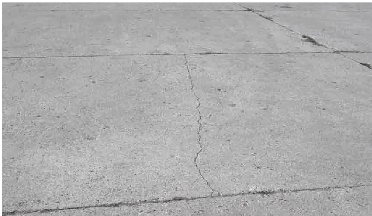
Rys. 5.2.2.4. Widok pęknięć poprzecznych
