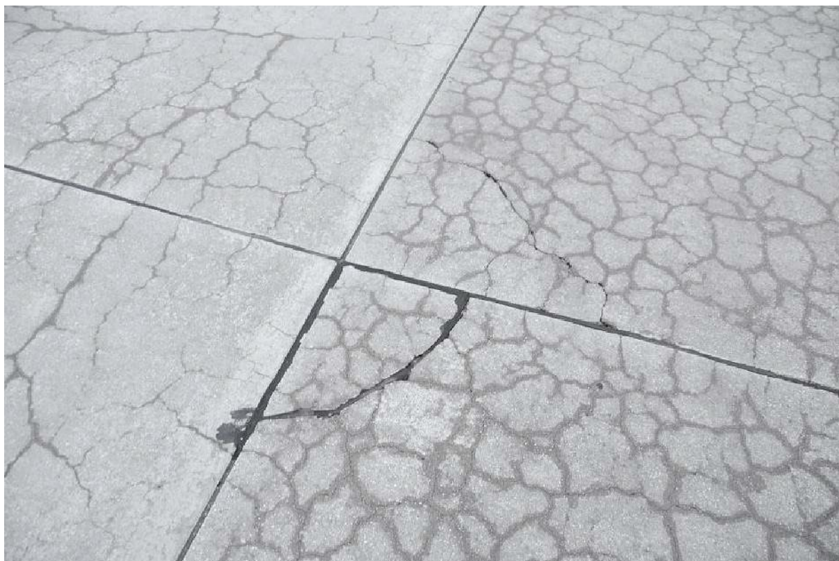
Rys. 5.2.3.5. Widok pęknięć alkalicznych
