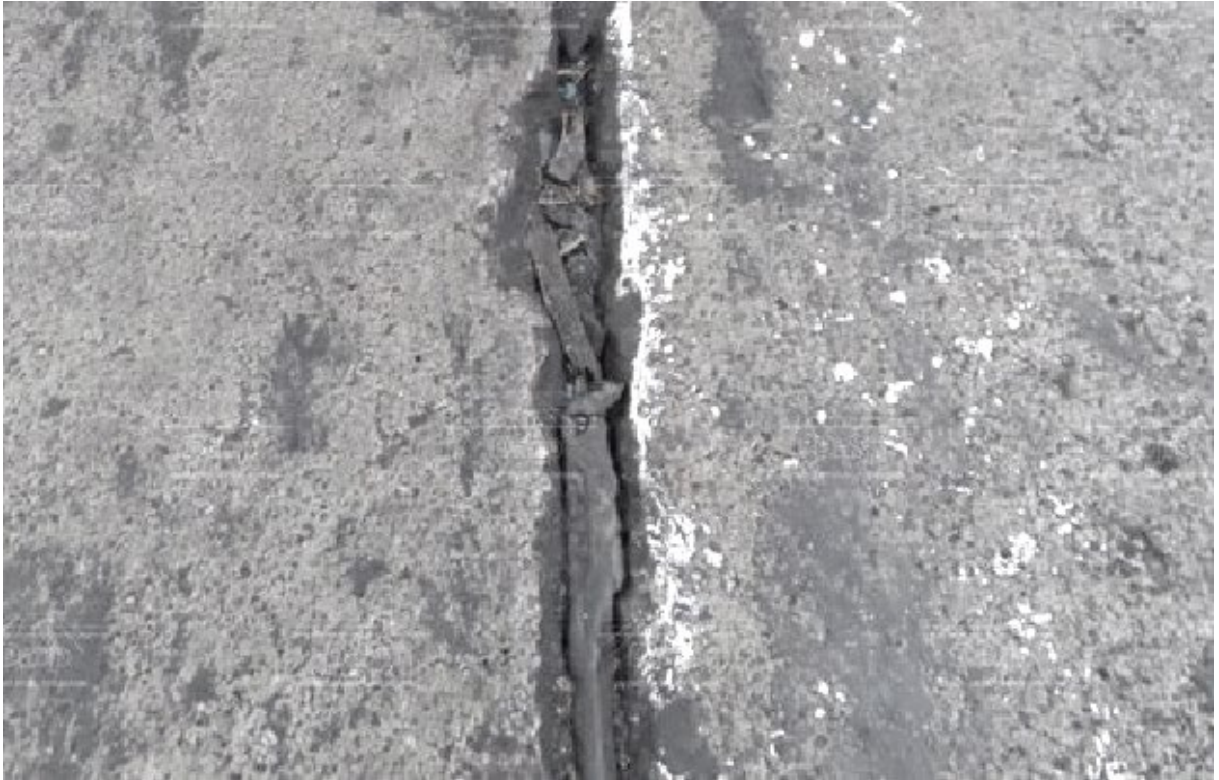
Rys. 5.2.4.4. Widok uszkodzenia wypełnień w szczelinie
