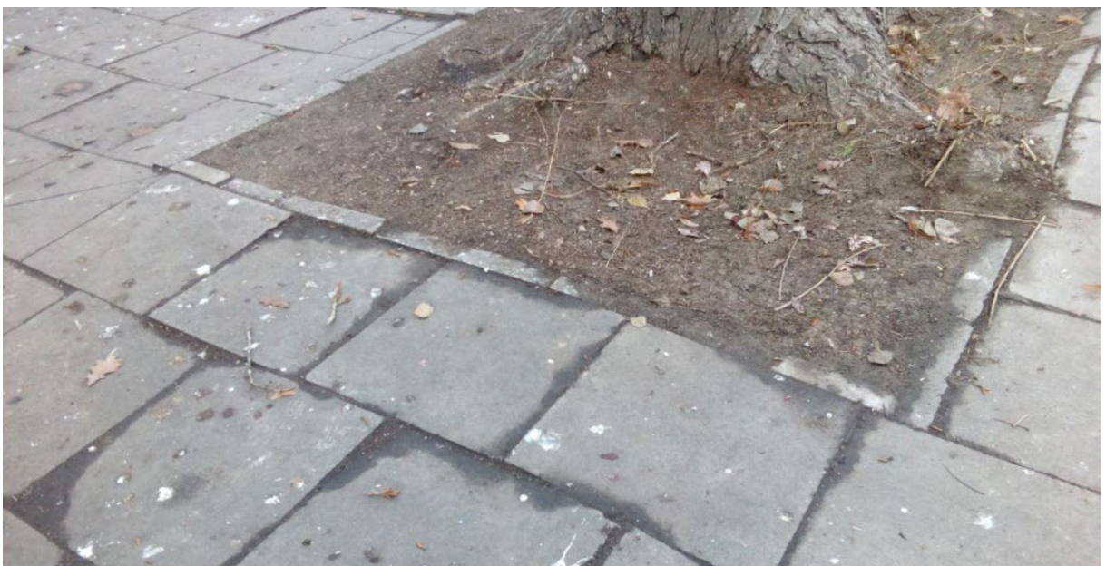
Rys. 6.3. Sfalowania płyt betonowych spowodowane korzeniami drzew
