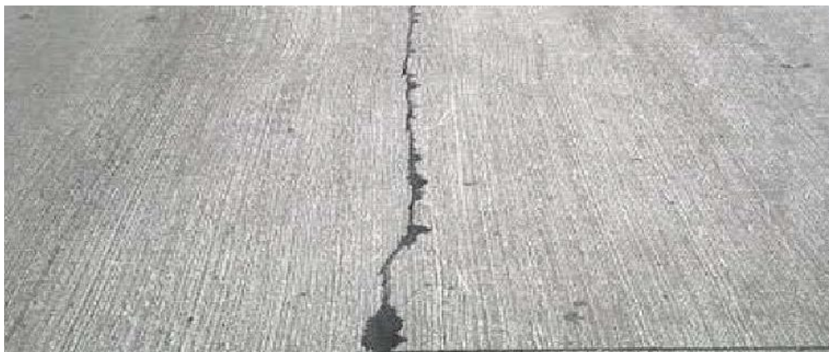
Rys. 5.2.2.1. Widok pęknięcia podłużnego na długości płyty
