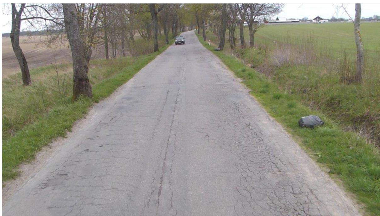
Rys. 5.1.2.4. Stan zły: spękania siatkowe zajmujące ponad 50% powierzchni [6]
