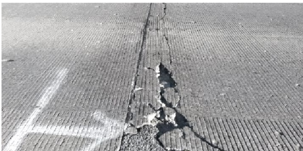
Rys. 5.2.5.1. Widok uszkodzeń z powodu nieprawidłowej pracy dybli
