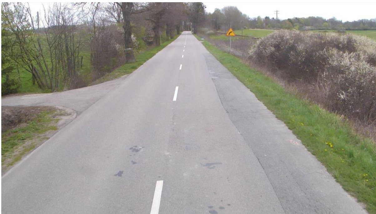
Rys. 5.1.3.4. Stan niezadowalający: łaty zajmujące do 20% powierzchni [6]
