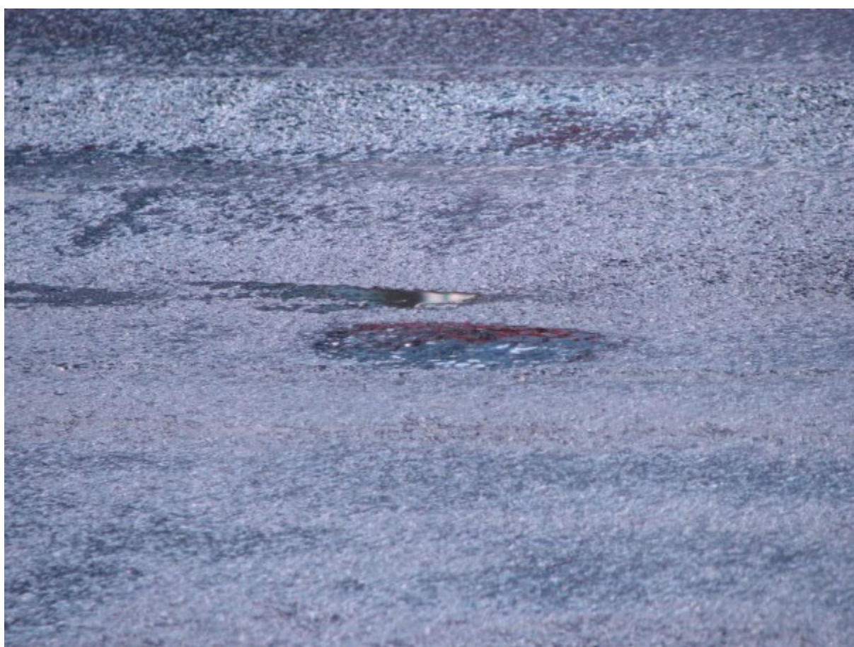
Rys. 5.1.3.8. Wypływ (plamy) lepiszcza
