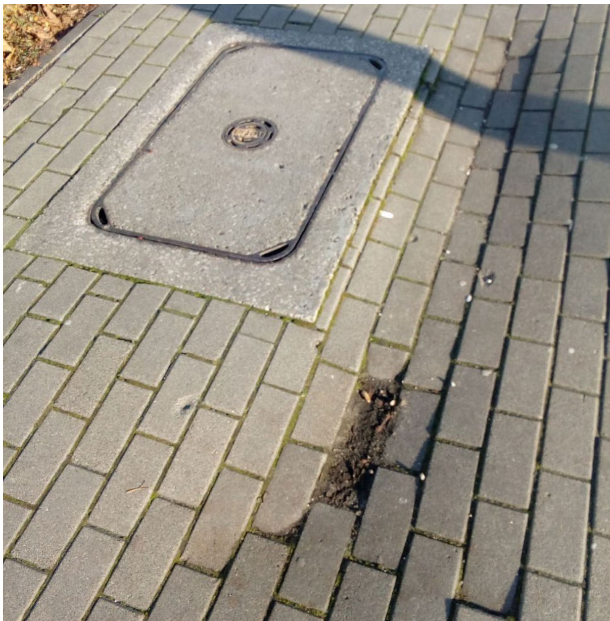
Rys. 6.5. Zapadnięcia lokalne bez ubytków
