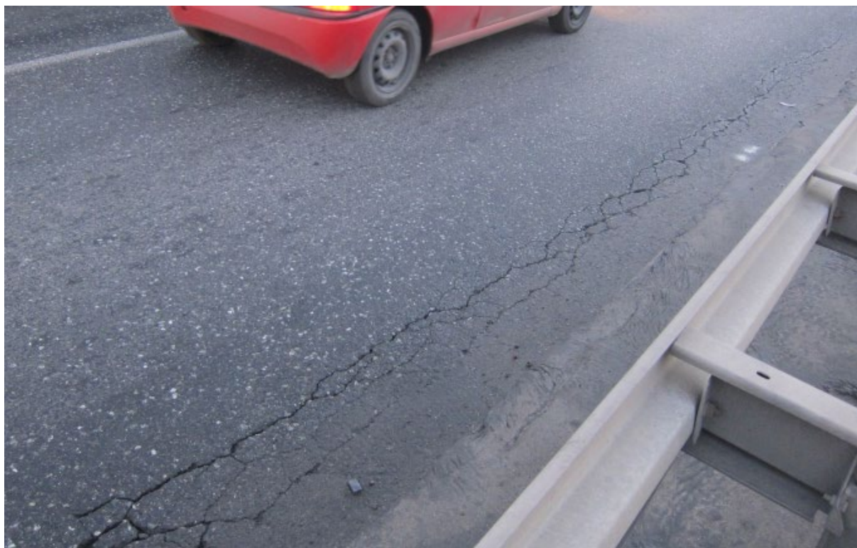
Rys. 5.1.2.7. Spękania zmęczeniowe podłużne (w śladzie nierówności poprzecznej)
