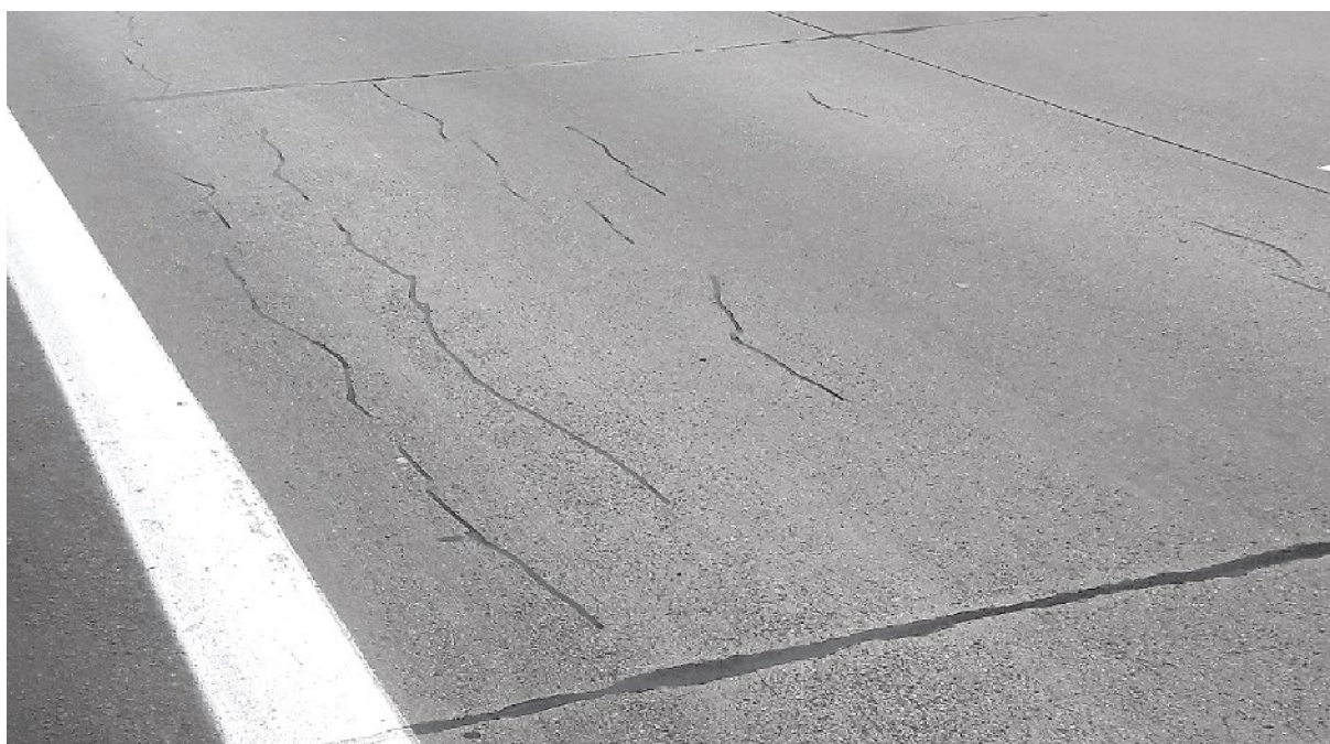
Rys. 5.2.2.2. Widok krótkich pęknięć podłużnych
