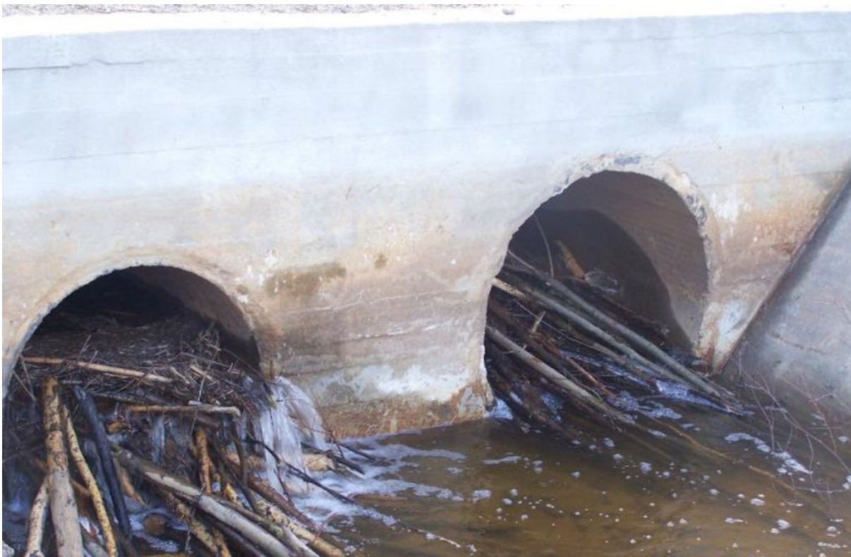
Rys. 7.2.3. Przepusty niedrożne powyżej 30% – stan zły
