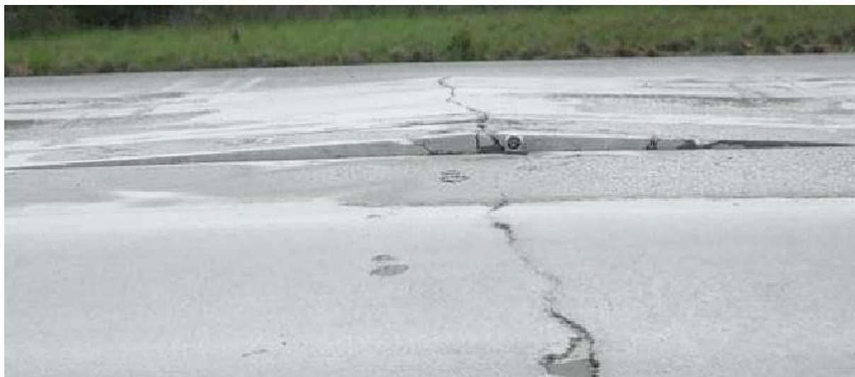
Rys. 5.2.1.4. Widok deformacji podłużnych na długości płyty
