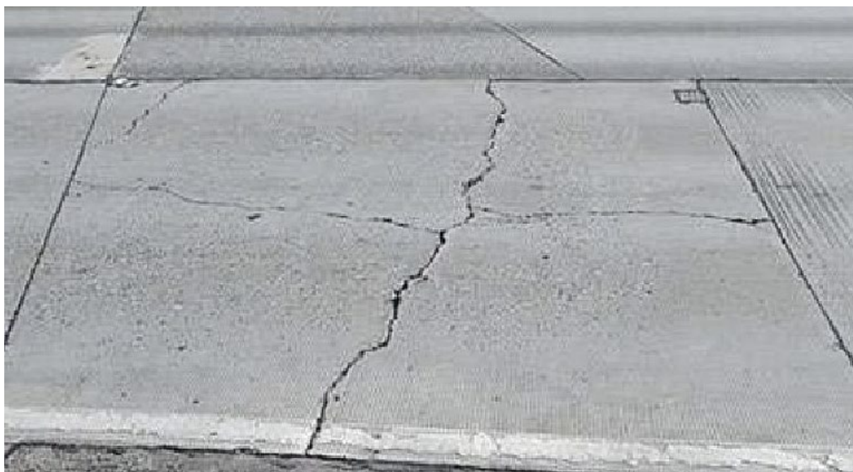
Rys. 5.2.2.9. Widok pęknięć blokowych
