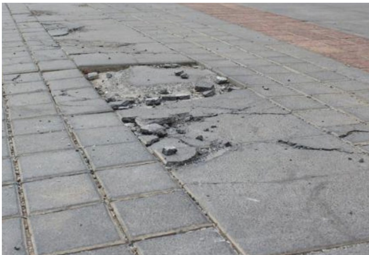
Rys. 6.10. Głębokie złuszczenia płyt chodnikowych z betonu cementowego
