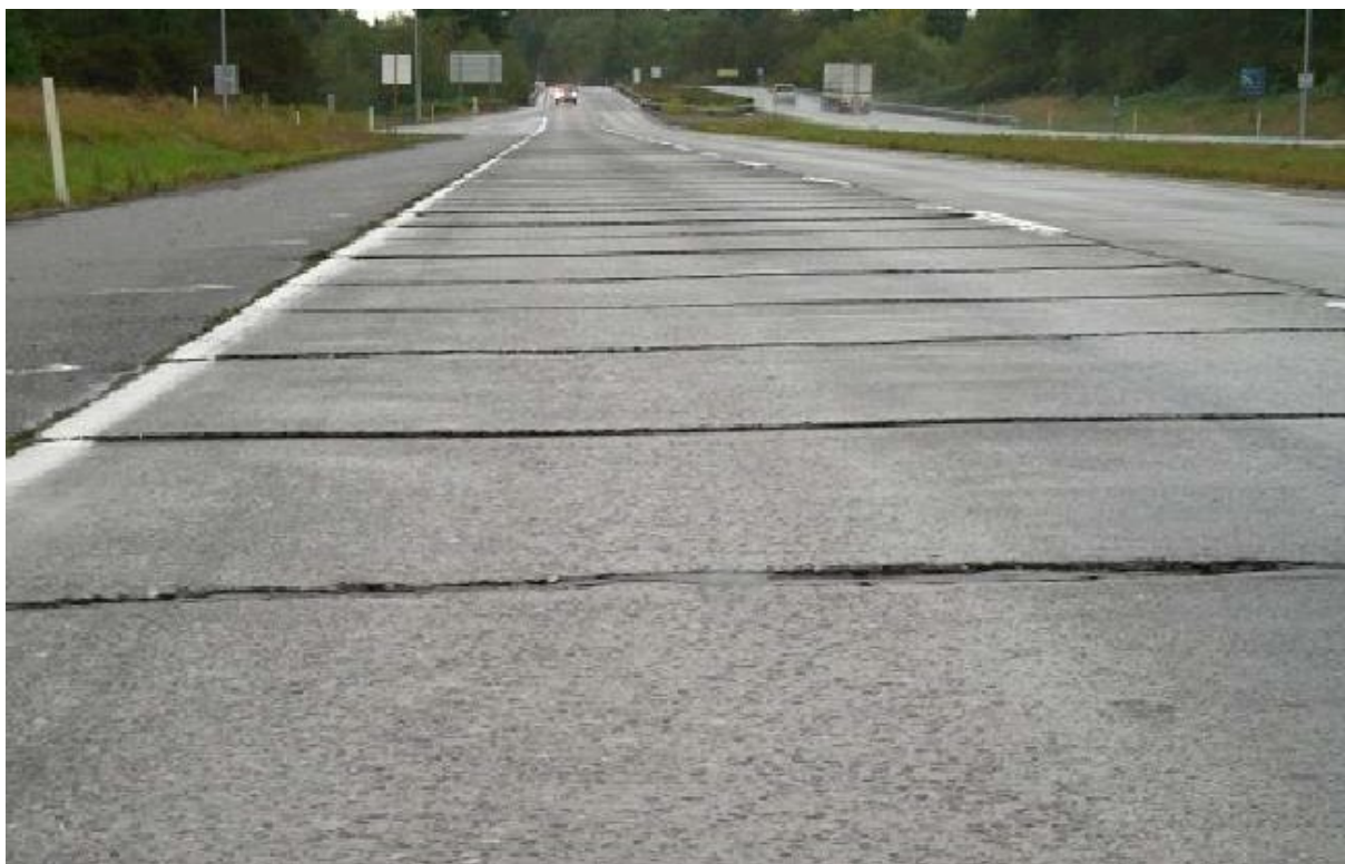
Rys. 5.2.1.6. Widok uskoków płyt
