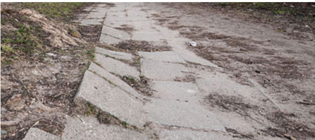
Rys. 6.1. Sfalowania płyt chodnikowych
