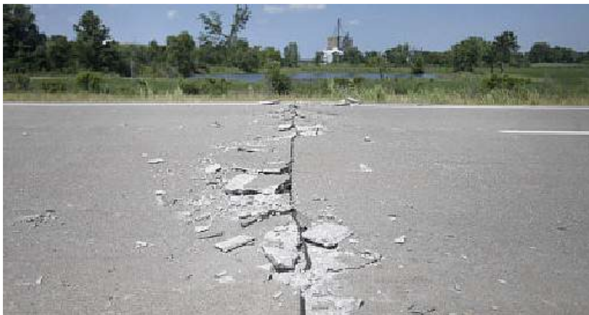
Rys. 5.2.4.2. Widok uszkodzenia szczeliny płyty
