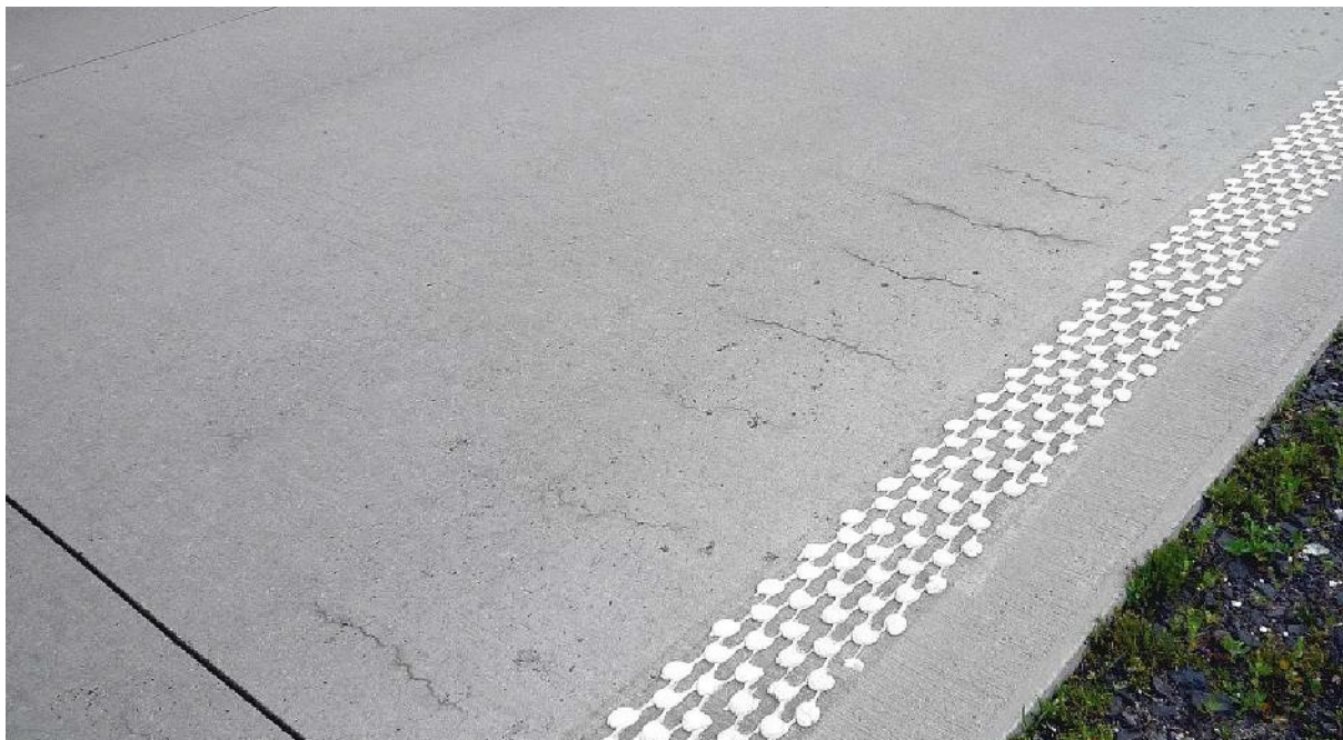
Rys. 5.2.3.7. Widok pęknięć spowodowane niewłaściwą pielęgnacją
