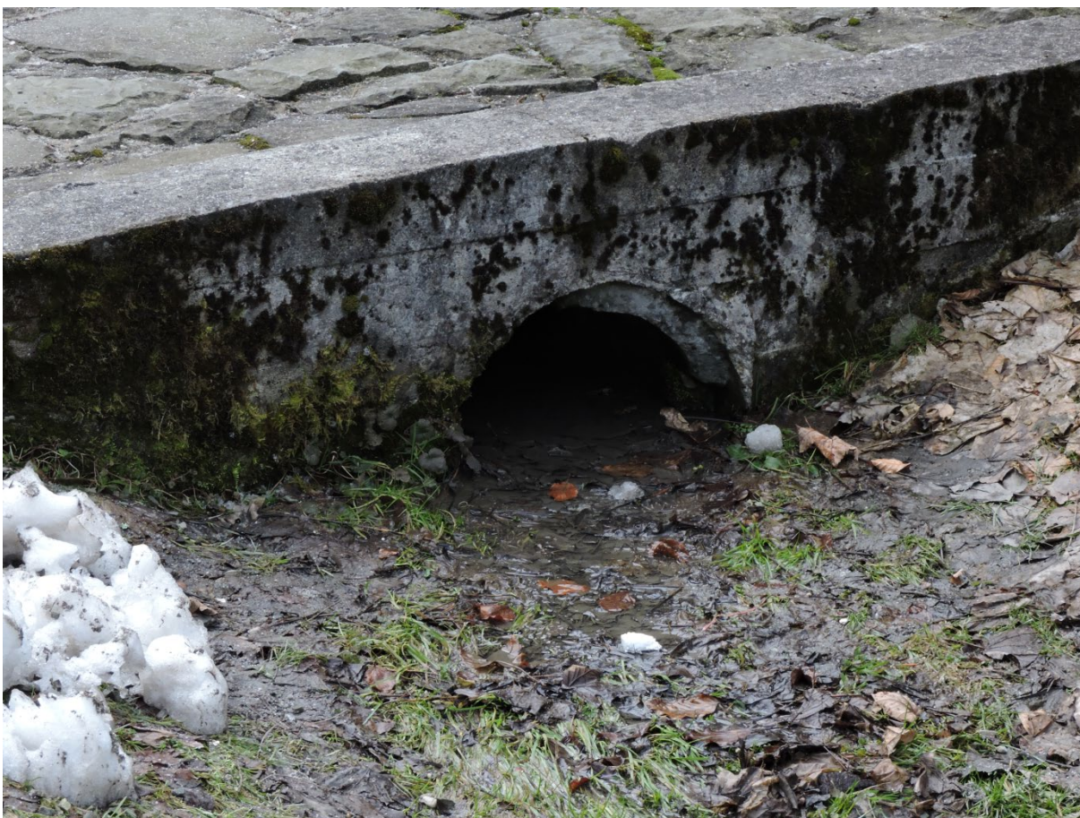
Rys. 7.2.4. Przepust niedrożny powyżej 50% – stan zły
