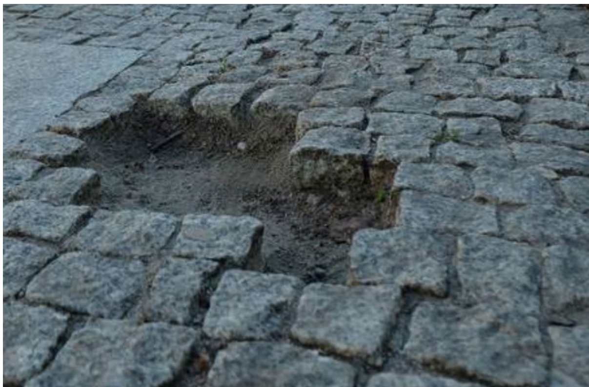
Rys. 6.9. Braki elementów chodnika z kostki kamiennej
