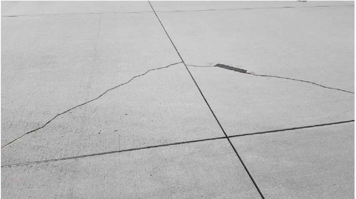
Rys. 5.2.2.6. Widok pęknięcia naroża
