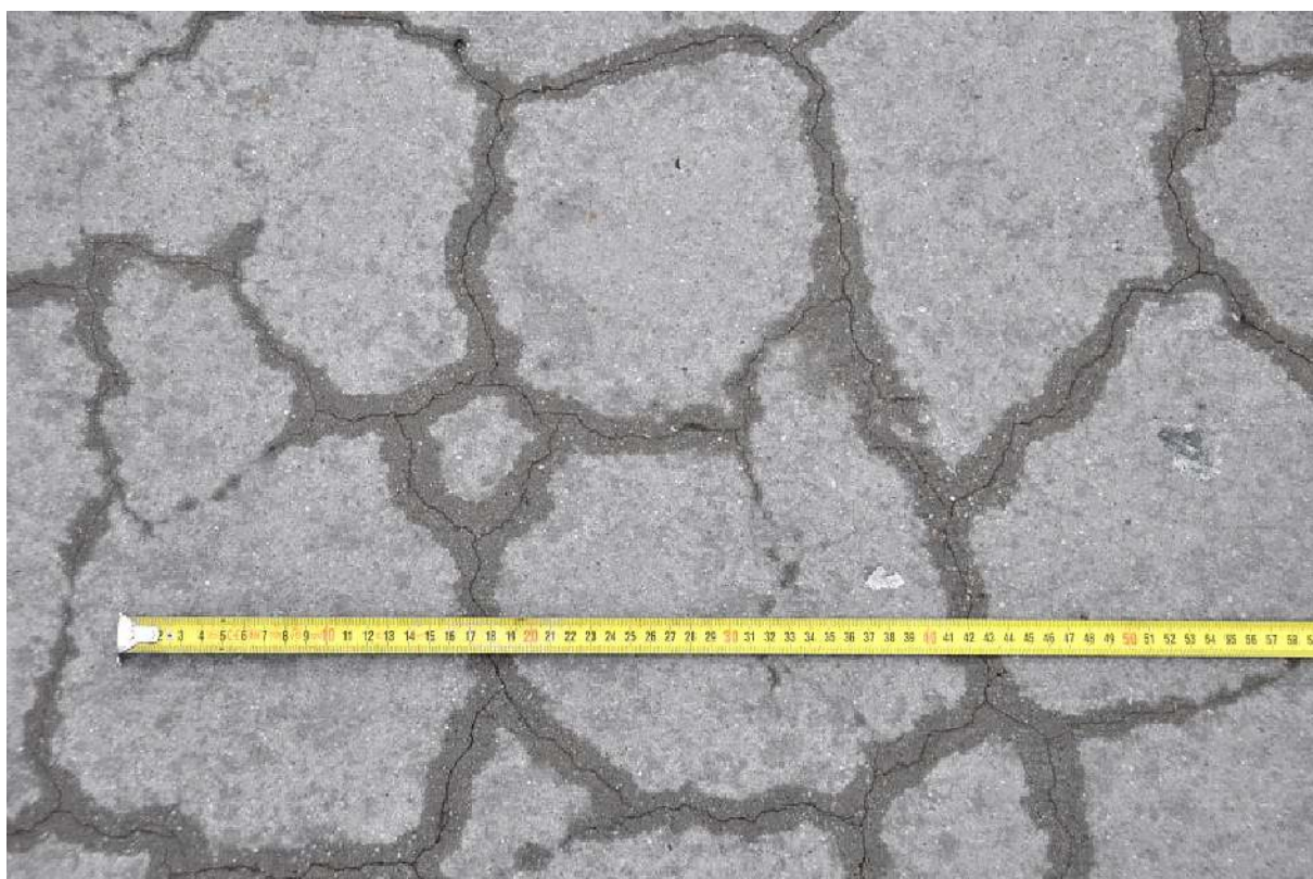
Rys. 5.2.3.6. Widok pęknięć alkalicznych
