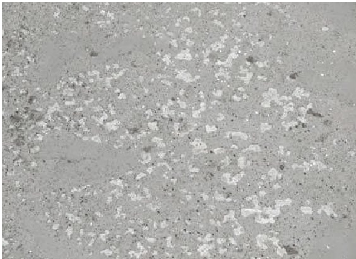
Rys. 5.2.3.10. Widok ubytków ziaren/lejków
